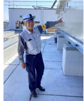
電気管理技術者としてのキュービクルの点検中
