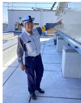
電気管理技術者としてのキュービクルの点検中
